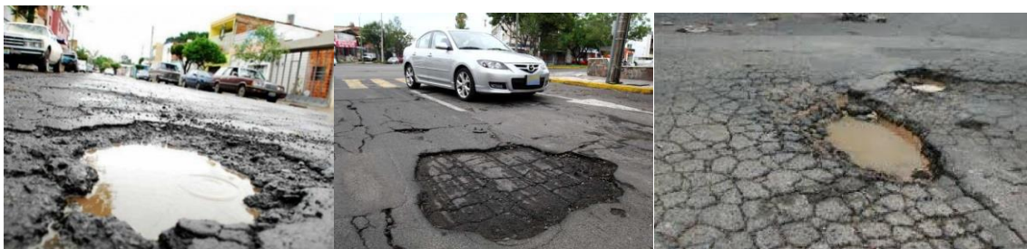
Figura 1. Daño por humedad en vías mexicanas (Excélsior, 2015)
