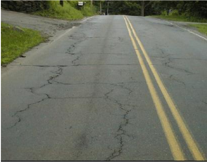
Carretera en malas condiciones
