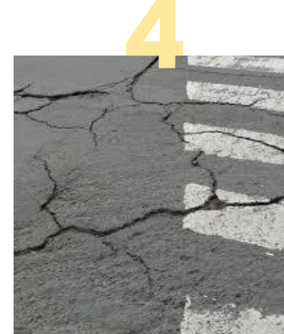
GRIETAS TIPO MAPA
