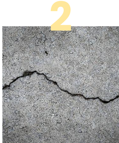
GRIETAS EN ZIG ZAG
