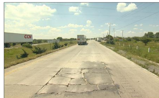
Fig. Reparaciones dañadas
