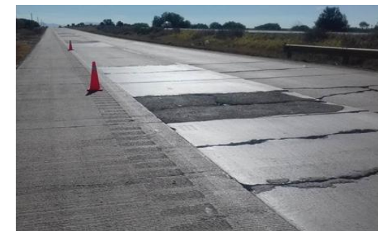
Fig. Reflexión de grietas y reparaciones dañadas
